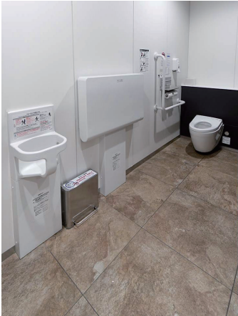
3F 52番ゲート前 男性トイレ 大便器ブース
