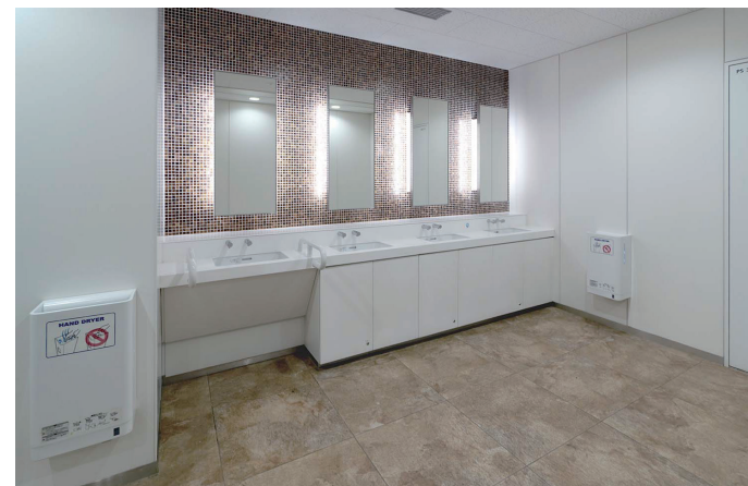
3F 52番ゲート前 男性トイレ 洗面コーナー
