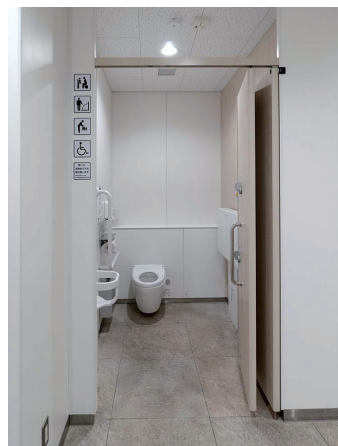
3F 52番ゲート前 女性トイレ 大便器ブース
