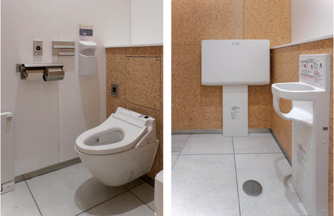
4F東 女性トイレ大便器ブース
