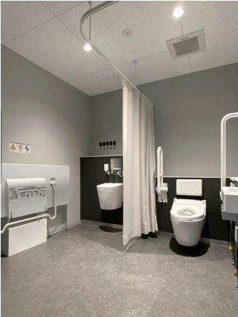
3F 北東デッキ バリアフリートイレ
