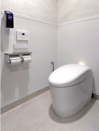
女性トイレ 大便器ブース
