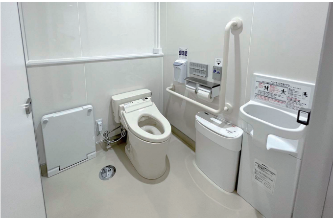
女性トイレ 大便器ブース
